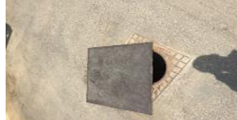
(أ) وجود فتحة صرف صحي غير محكمة الاغلاق ومكشوفة في ارتداد المصنع الداخلي
