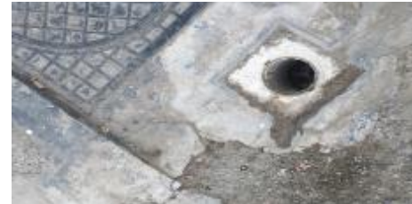
(ج) وجود فتحة تصريف صحي مفتوحة في الارتداد الداخلي للمصنع
